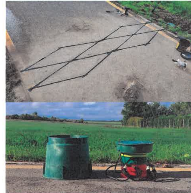
Figura 161: Bucă de inducție proaspăt instalată în pavajul unei piste de biciclete și componentele electronice ascunse în subteran (sursa: Eco-Counter)
