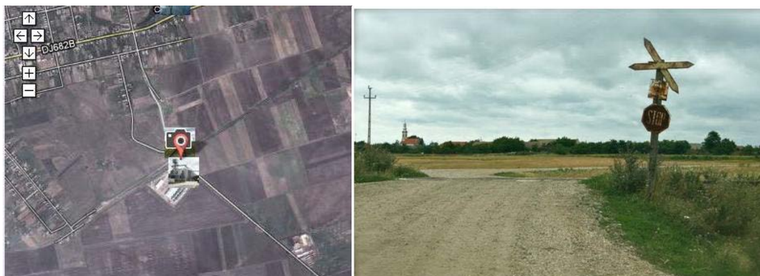
Figura nr. 31 Trecere la nivel într-o stare avansată de degradare - Valcani
